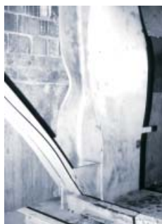
Durch Brandschaden verformter Stahlträger
