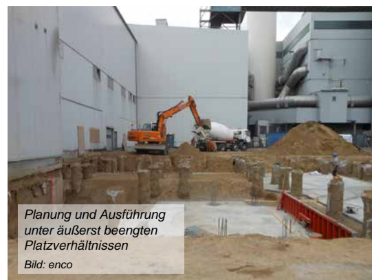
Schaltanlagegebäude Ebene 5,00 m Bild: enco
