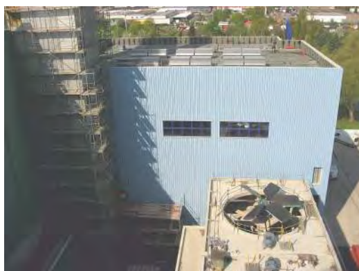
Ostansicht des Maschinenhauses und Dachaufsicht auf den Verdunstungskühlturm mit Ventilatoren
