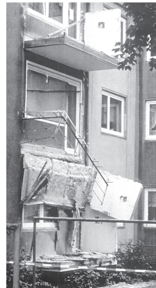
Dieser Balkon-Schaden verlief zum Glück ohne Gefährdung von Bewohnern und Passanten.
