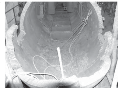
Obere Dampftrommel, 64mm Wandungsstärke Vollstahl, Länge ca. 8,00 m, Durchmesser d=1600 mm
