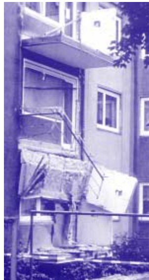
So hätte auch der im Text beschriebene Balkon "enden" können: Die Konstruktion auf diesem Bild knickte aufgrund ihrer Schäden ab und gefährdete Bewohner und Passanten.
